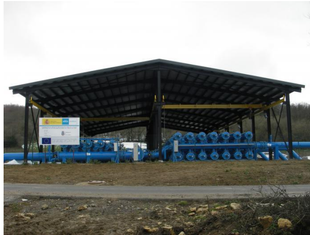
Planta filtración Ebro-Besaya (fuente: https://www.acuaes.com/actuacion/planta-de-filtrado-del-trasvase-reversible-ebro-besaya )
